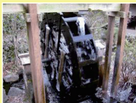
【小水力発電設備の導入】
